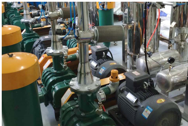
自动化系统中真空产生及监控
